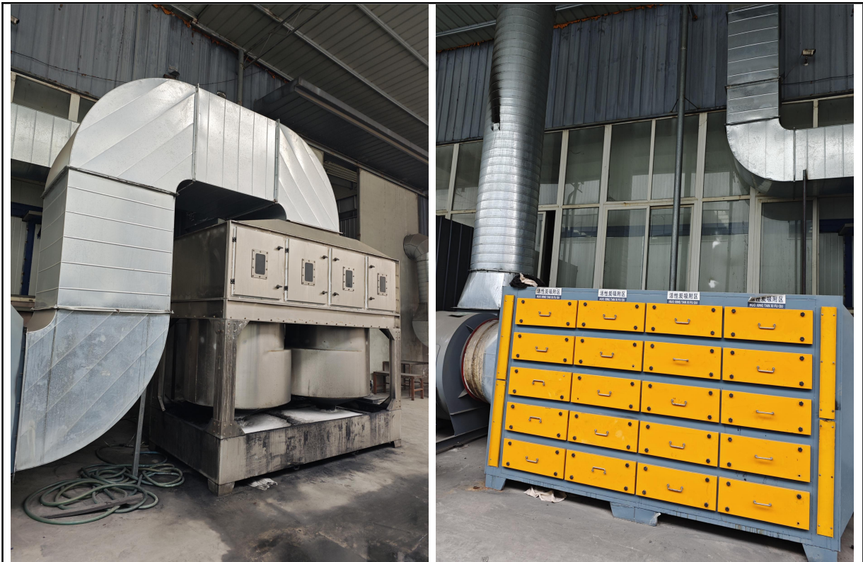
喷淋塔+干式过滤+二级活性炭吸附装置
