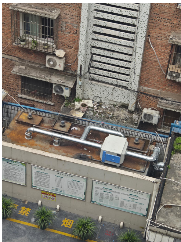
废水处理系统臭气活性炭吸附装置
