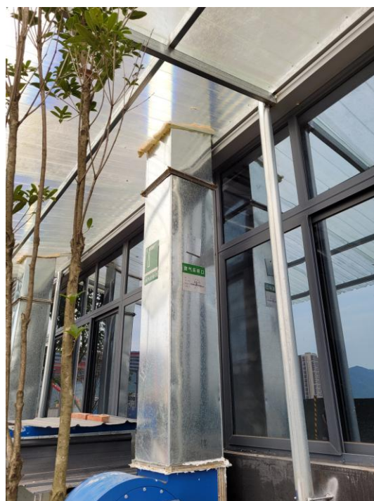
切割、焊接废气排气筒 DA002
