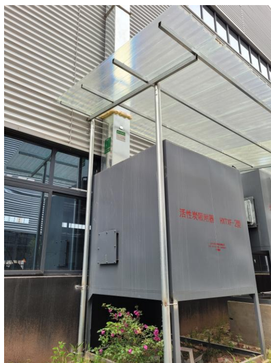
喷漆、晾干废气排气筒 DA001
