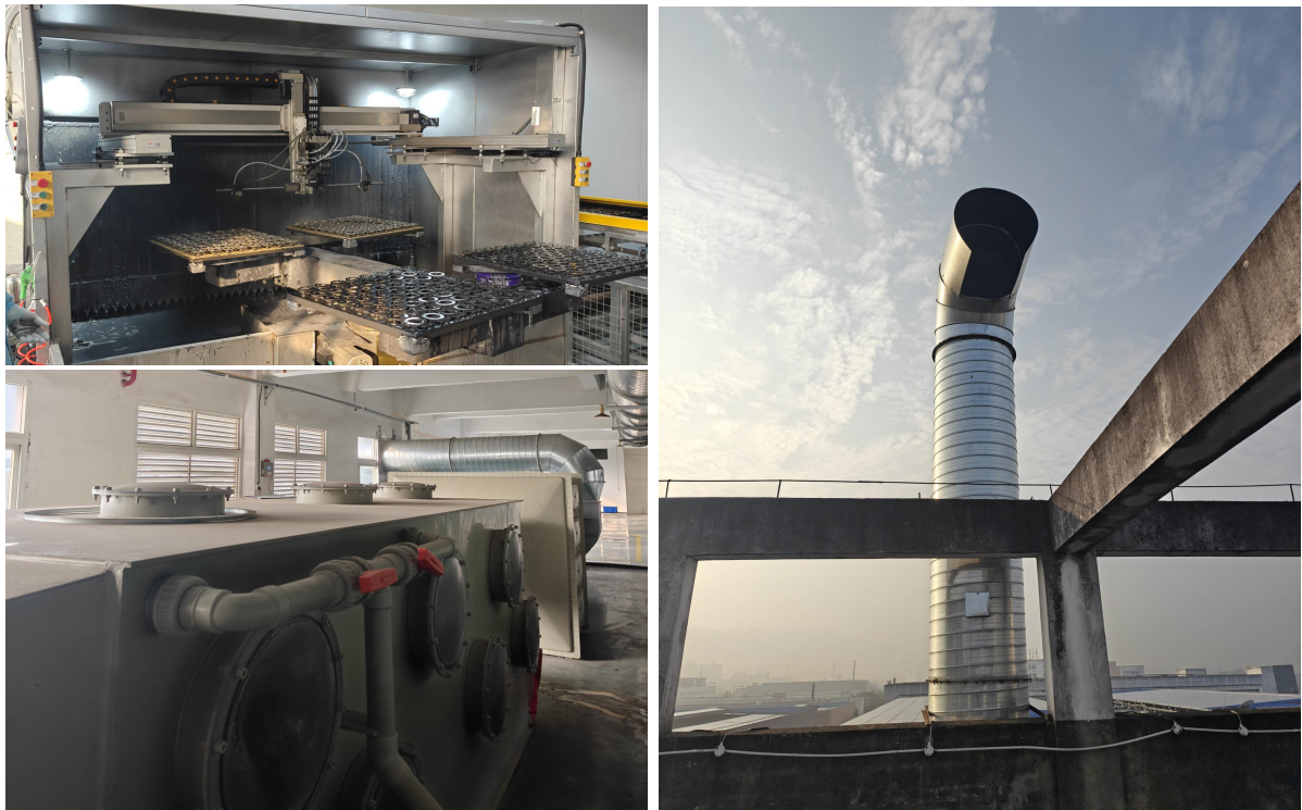
水帘+“喷淋塔+干式过滤+二级活性炭”+DA002 排气筒
