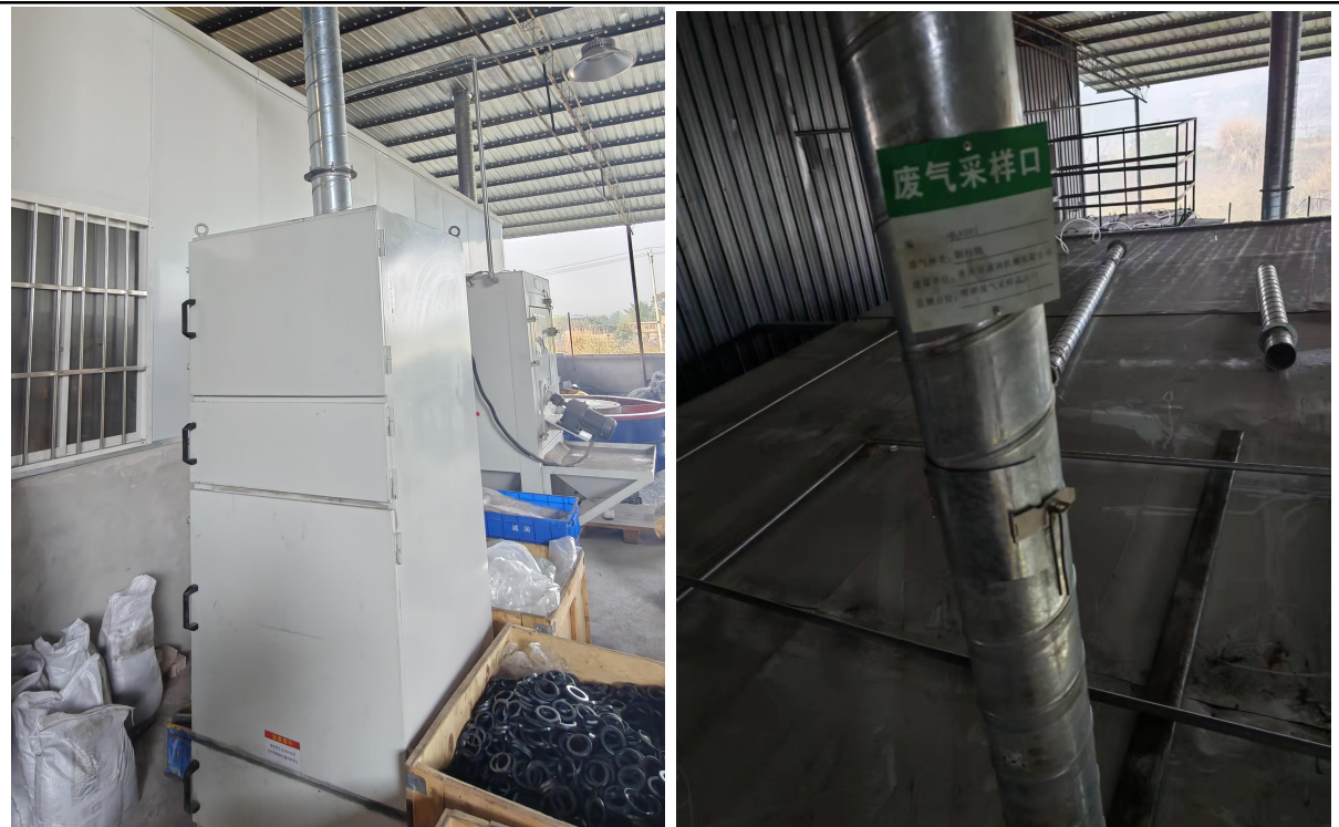
脉冲集尘器+DA001 排气筒
