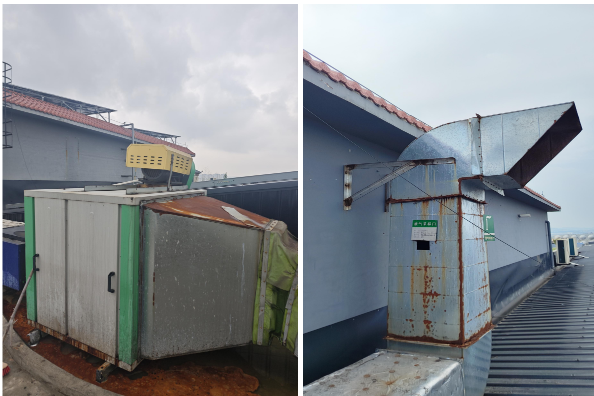
静电式油烟净化器+排气筒（DA001）
