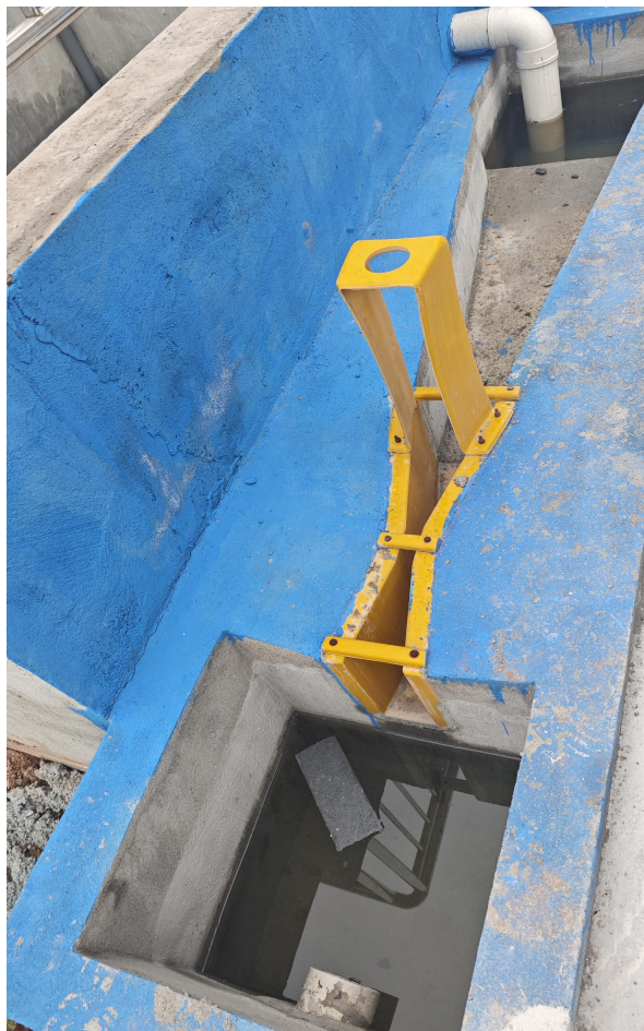
污水处理站排放口
