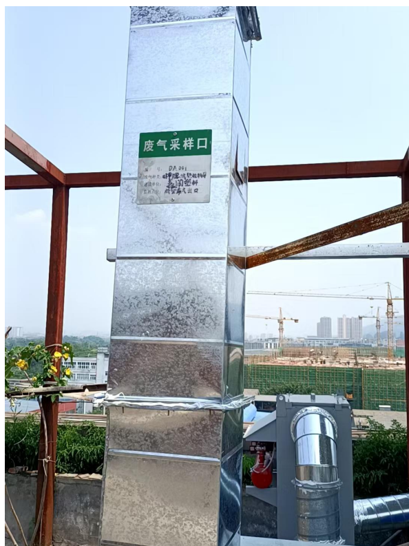
挤塑废气排放口标识牌
