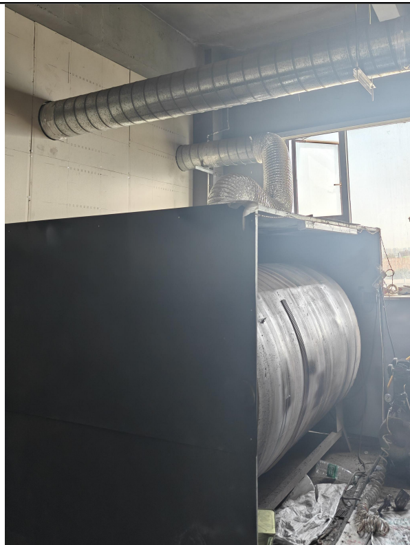
废气收集管道
