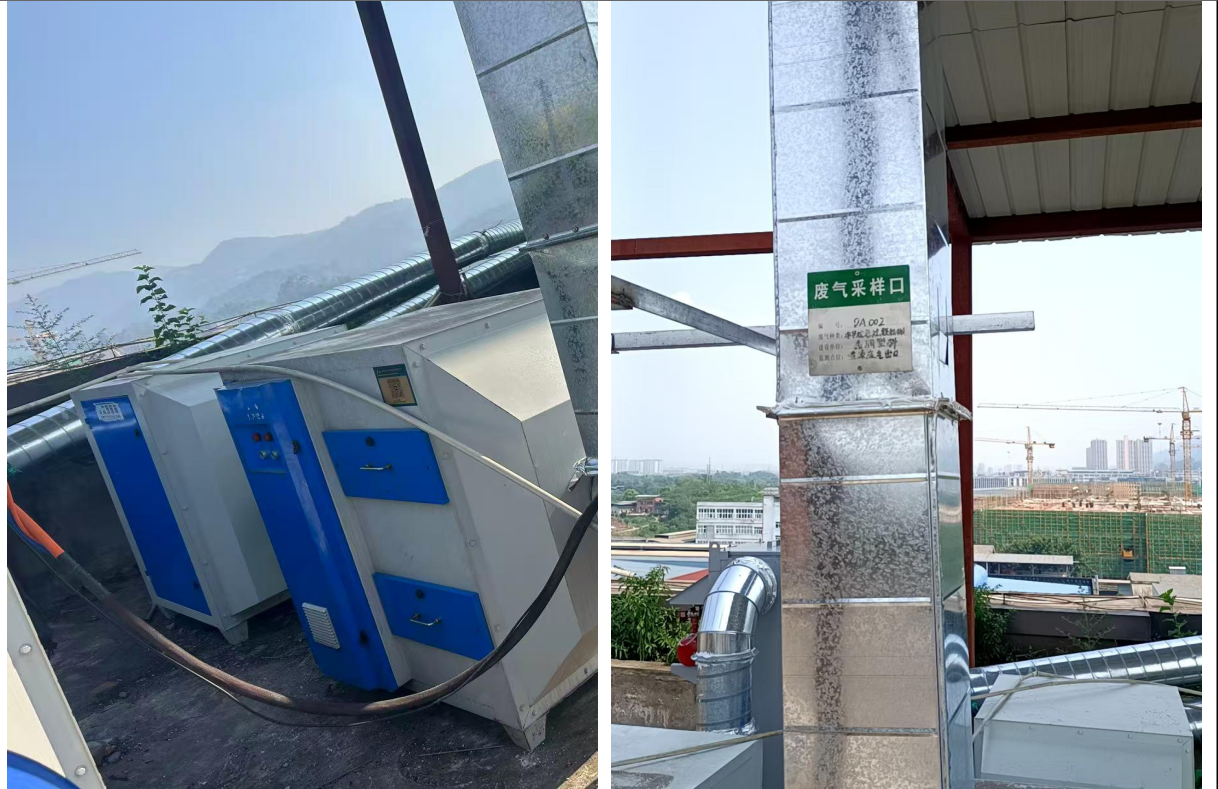
干式过滤+二级活性炭吸附装置
